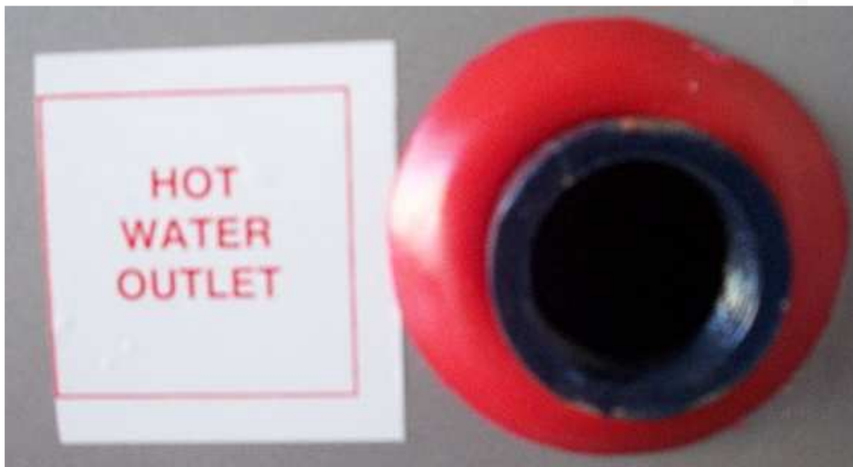
Fig 15.- Salida agua caliente.
