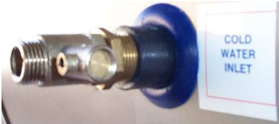
Fig 14.- Entrada agua fría.
